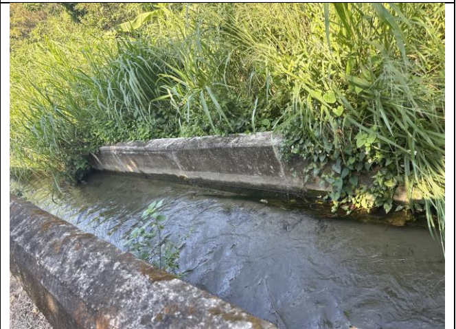
說明：圳路右側漏水，造成後方土壤受潮崩塌。
