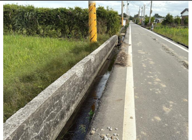
說明：工區 4-1 緊鄰交通頻繁道路，路面已有部分破損。
