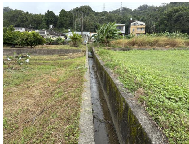
時間：114 年 10 月 20 日 說明：115 年度五鶴山重劃區尖山段 1979-3 地號大灣埤圳小給 1 之 5 等水路改善工程
