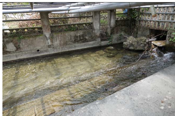
圖 21、七十分圳堤下現況
